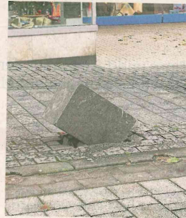
Immer wieder werden Steinquader in der Innenstadt beschädigt. FOTO: REHSE
